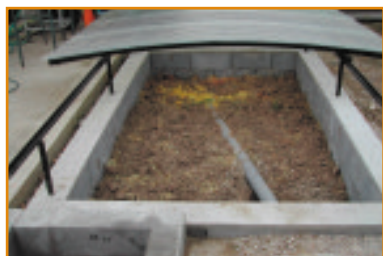
Exemple de lit biologique avec arrivée des effluents directement par drain (Lycée de Nermont-28)
